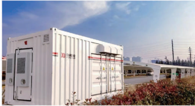
西安某光储充储能项目
