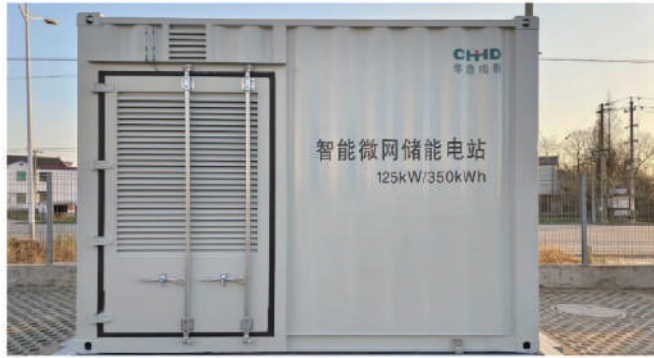
扬州某光储充项目
