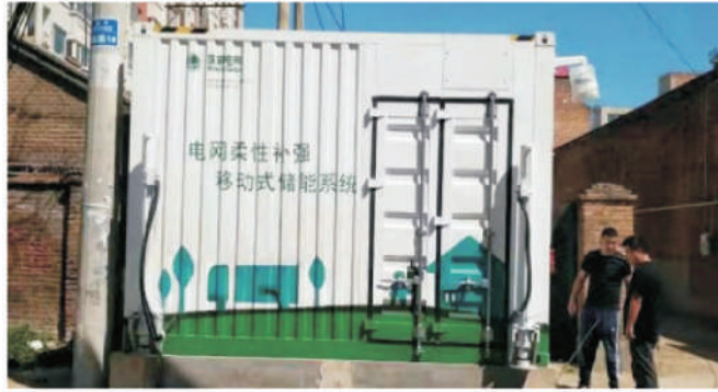
雄安某移动储能项目
