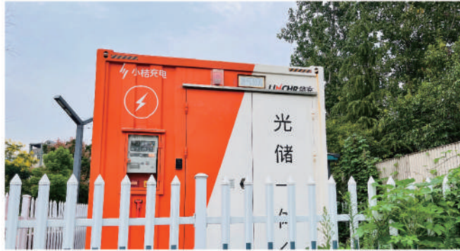
杭州某光储充储能项目
