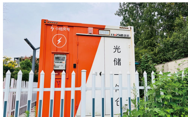
■ 杭州小桔光储存项目
