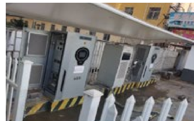
■ 云南电网玉溪综合能源站项目
