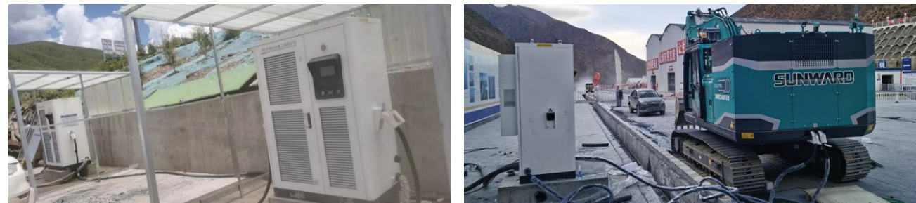
■ 新能源宽体自卸车充电桩项目
