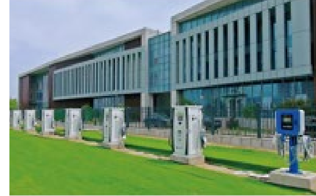
■ 杭州萧山直流配电项目
