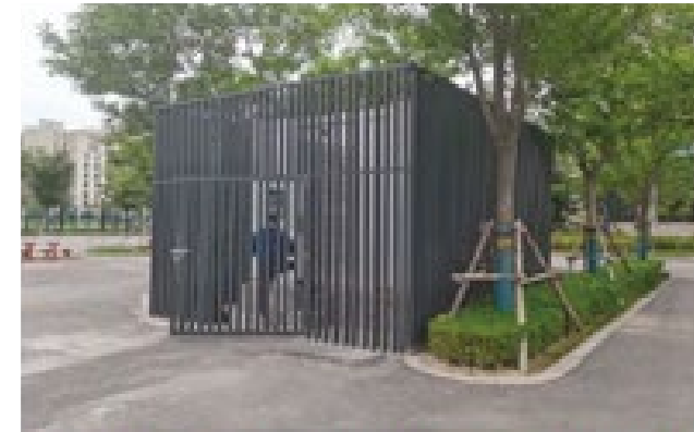
■ 隆基交大创新港光储充微网项目
