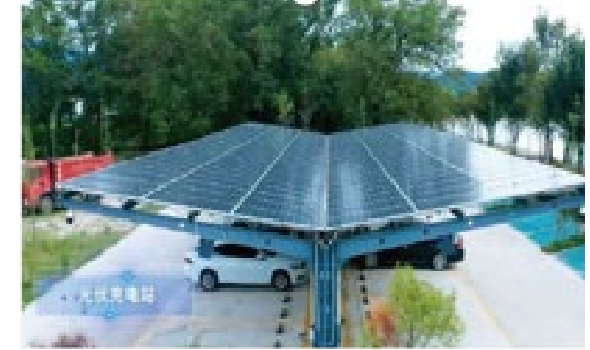
■ 温州水光储充微网项目
