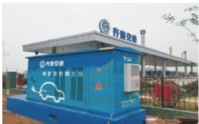
■ 齐鲁交通微电网项目
