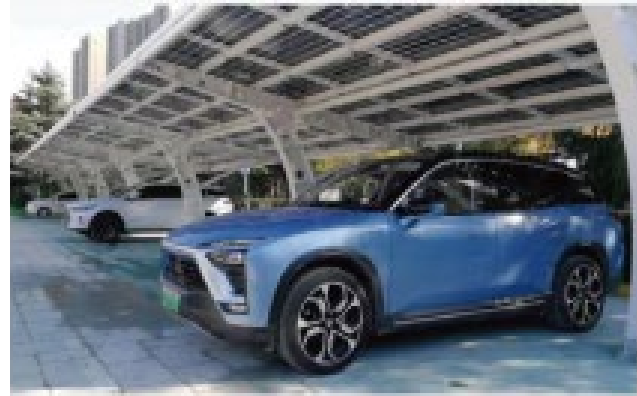
■ 西电集团微电网项目
